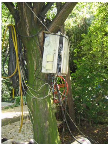
Armoire électrique desservant plusieurs bateaux
