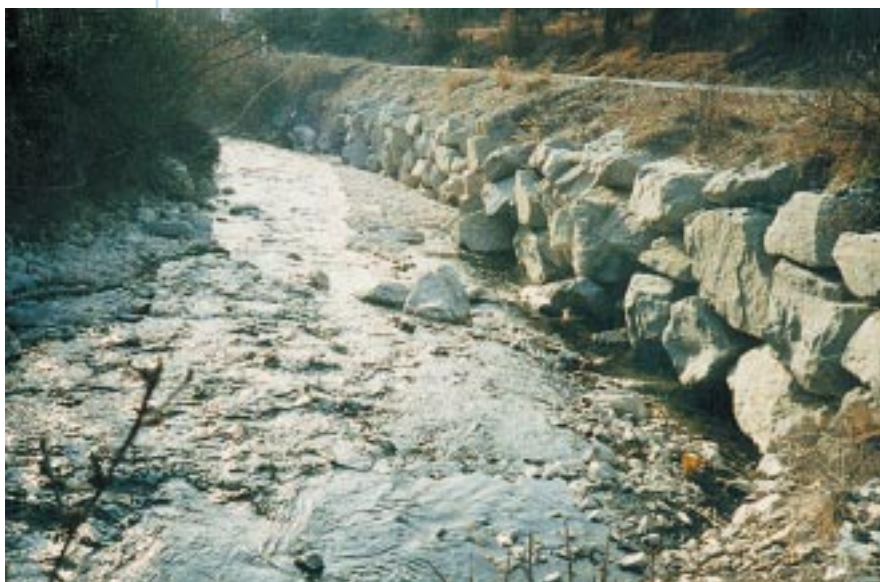
La protection d'une berge contre l'érosion peut parfois avoir des effets inverses à ceux recherchés. Ici, la protection a provoqué l'enfoncement de la rivière, entraînant à terme le déchaussement de l'enrochement.
