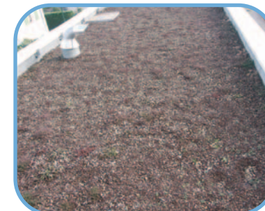
Mordelles (35) : la toiture végétalisée permet de retenir 50 à 100 % des précipitations. De plus, elle contribue à la lutte contre le changement climatique.
