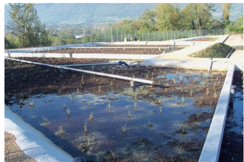
Traitement par Filtre planté de roseaux mis en place à la Plateforme de Champlat (73) (Source : Chambéry Métropole)
