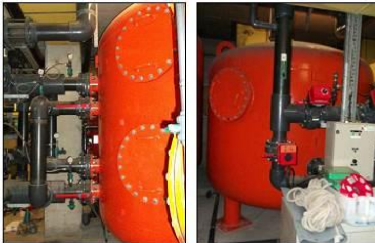
Système de filtration (source : CALB, 2015)
