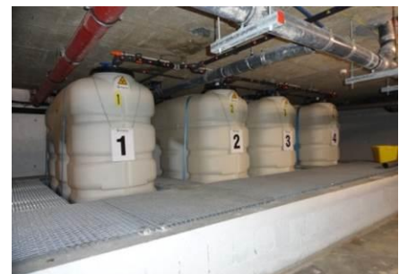
Cuves de décroissance radioactive
