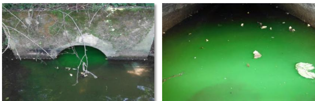
Figure 1 : Vues de la coloration constatée en sortie du collecteur public EP le 09/06/2016
