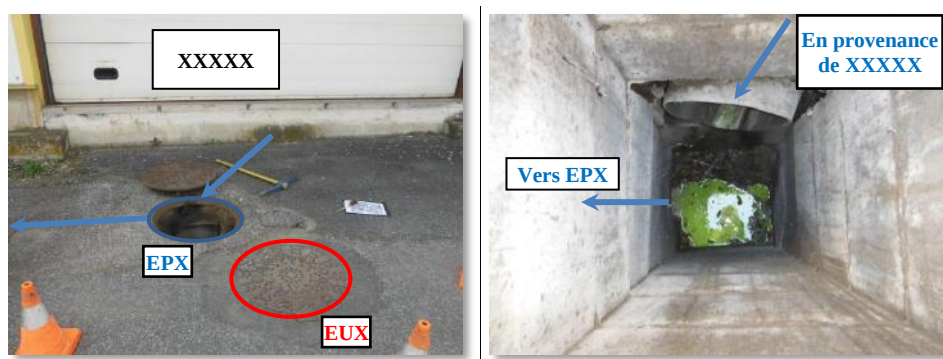
Figure 6 : Coloration constatée dans le regard EP4 en provenance de l'entreprise XXXXX
