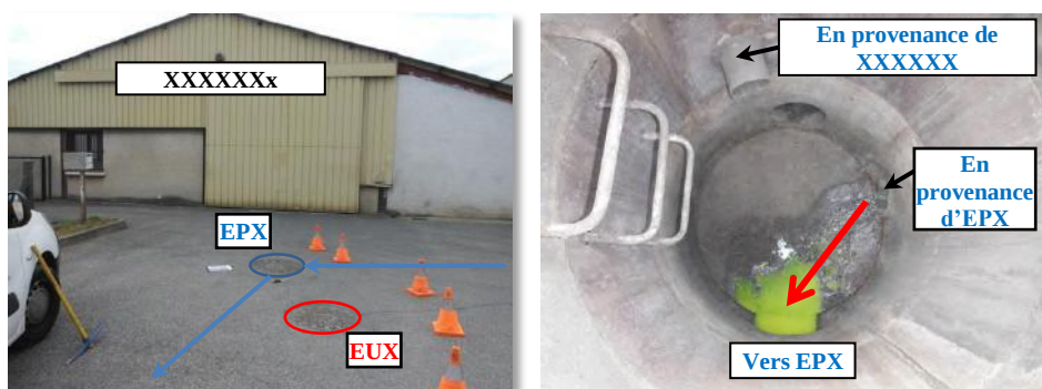
Figure 5 : Coloration constatée dans le regard EP3 en provenance de l'antenne reliée à EP4
