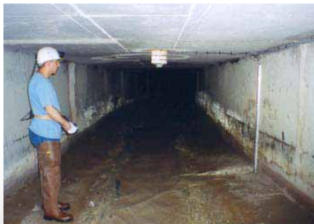
Exemple d'installation d'un capteur à US sous la voûte d'un collecteur sans renvoi d'angle (Photo Direction de l'eau et de l'assainissement de la ville de Marseille – SERAM)
