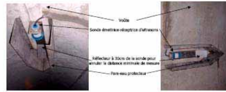
Exemple d'installation d'un capteur à US sous la voûte d'un collecteur avec ramon d'angle (photo ESX Grand Lyon)
