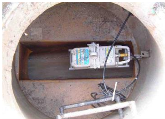
Illust. 2: Exemple d'installation en réseau ville de Mâcon – système compact (Photo Veolia eau)
