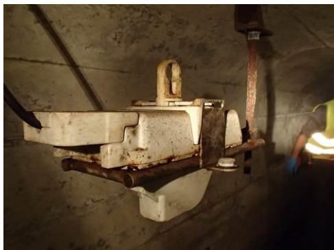
Illust. 1: Exemple d'installation en réseau système compact (Photo OTHU- Site expérimental Ecully)
