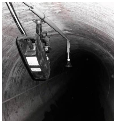
Illust. 3: Exemple d'installation en réseau Agglomération Villefranche Beaujolais– système modulable (Photo Agglomération Villefranche)
