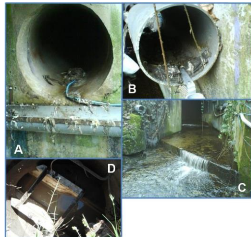
Figure 40: Profil en long du secteur fortement impacté par le déversoir d'orage de la station expérimentale de la rivière Chaudanne à Grézieu-la-Varenne, et photos du (A) canalisation de décharge du déversoir d'orage, (B) canal de dérivation pour la collecte des eaux de DO, (C) zone de rejet du DO au niveau de la rivière Chaudanne (amont fosse), et (D) réseau unitaire.
