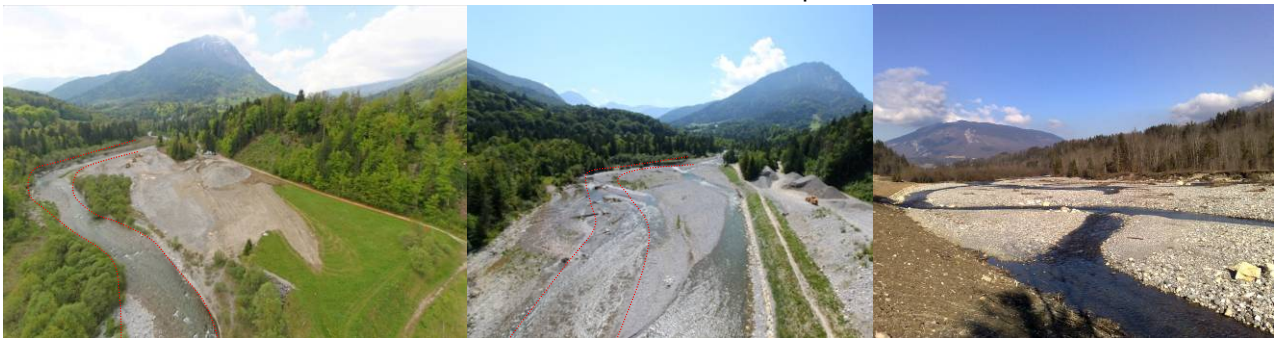
Amont du site : début des travaux (avril 2010), fin des travaux (juin 2010), observation février 2011
