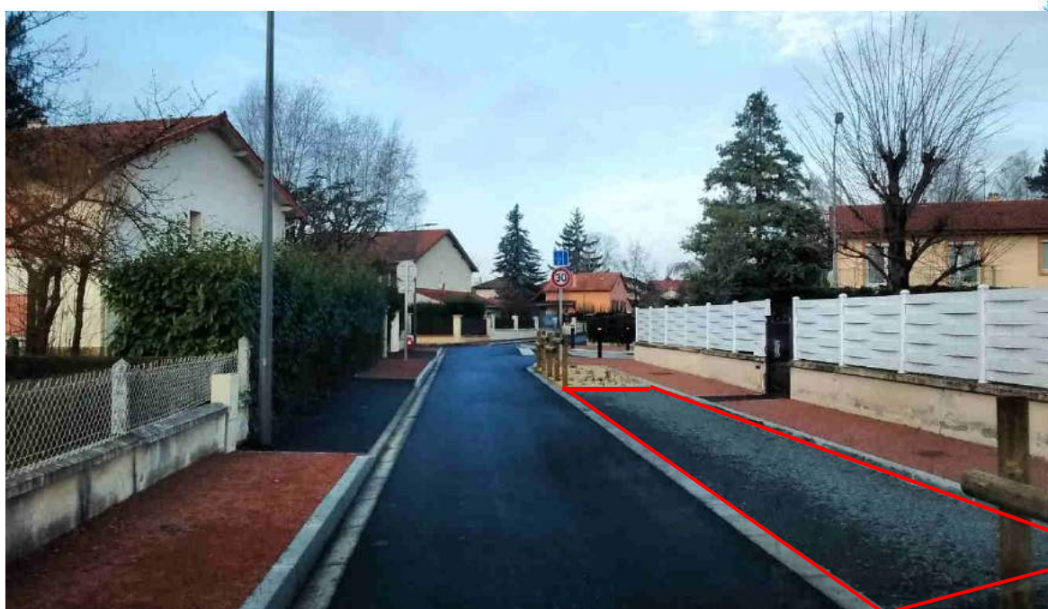
Zone de stationnement infiltrante
