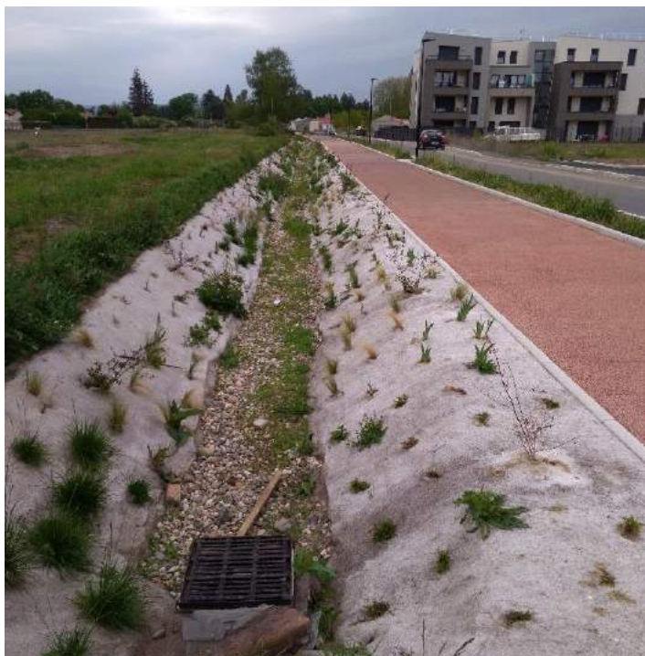
Noue 2 avec surverse en bas et béton drainant à droite
