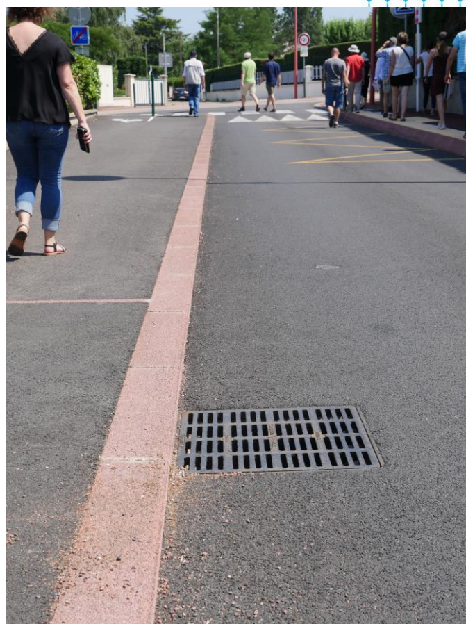
Grille de collecte dans un point bas
