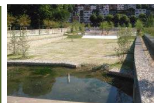
Bassin en eau (pluie annuelle)
