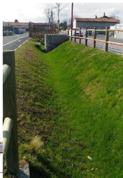
Noue de 280 m 3
