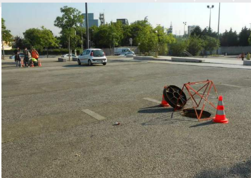
Regard de contrôle du bassin
