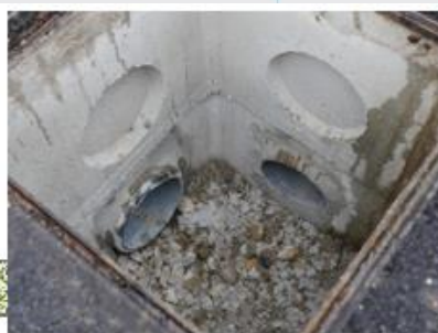
Regard de visite et drain de diffusion
