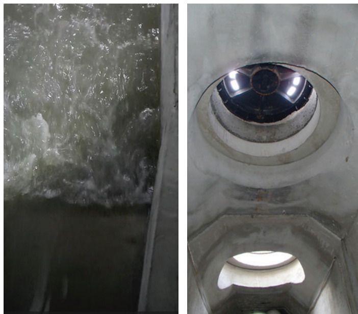
Gauche : Le ressaut hydraulique, caractérisé par un bouillonnement propice aux échanges liquide-gaz | Droite : regards destinés à l'installation du filtre (premier plan) et aux visites (second plan).
