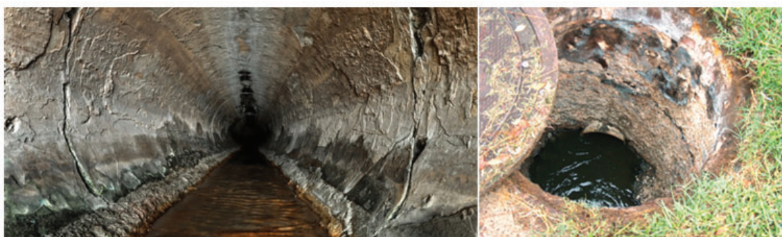
Figure 4. Phénomène de corrosion au niveau du ciel gazeux
